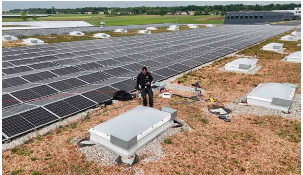
Der Ausbau von Photovoltaikanlagen auf Flachdächern nimmt weiter zu.
